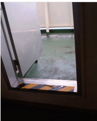
コーミングの段差
