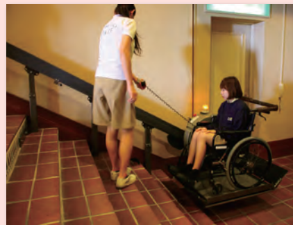
館内車いす専用昇降エレベーター
